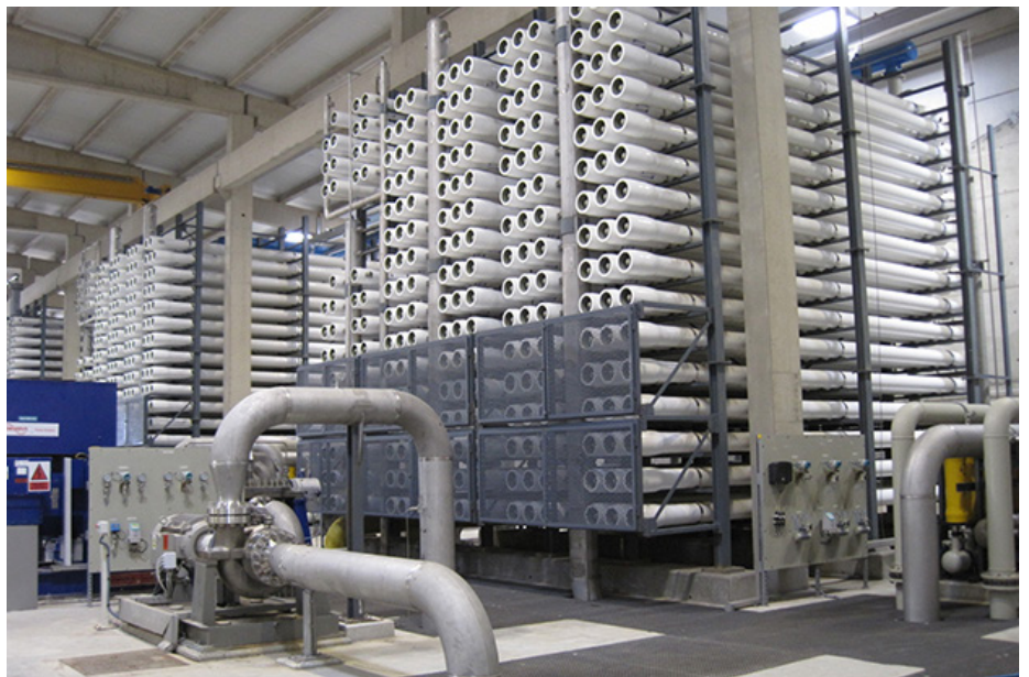
Bastidores de membranas de ósmosis inversa.
